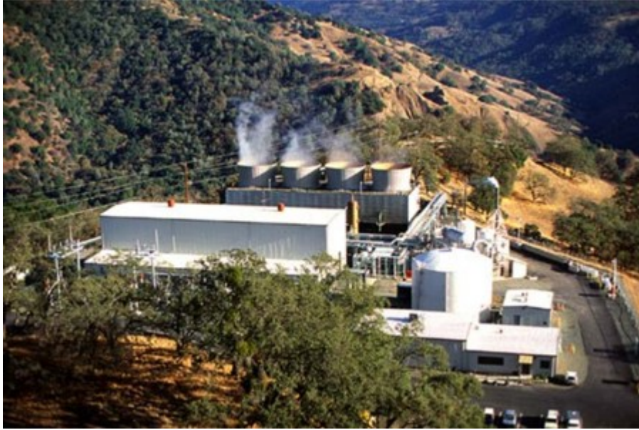
Aspecto de la central geotérmica de Wairakei (Nueva Zelanda).
